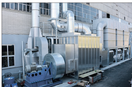
Fast fertig: Noch sind ein paar Schrauben locker, doch nächste Woche soll die Wärmeaustauschanlage in Betrieb genommen werden.
