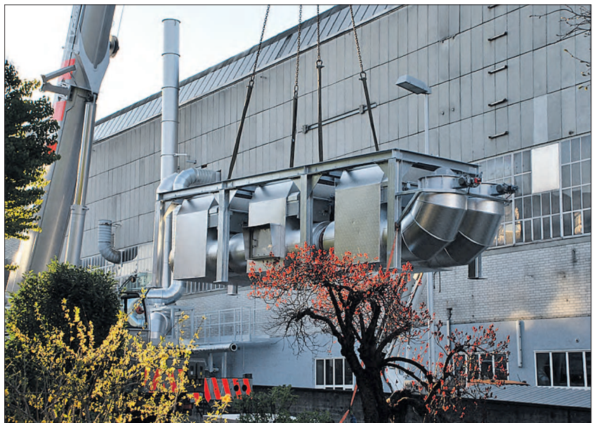
Präzisionsarbeit schon vor der Montage: Die Firma Allenspach Apparatebau aus Hermetschwil hat die eigens für die Metal Paint konzipierte Anlage geliefert.
